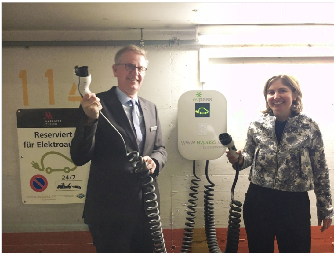
Freuen sich über die neu installierten Ladestationen: Daniel Lehmann, General Manager Marriott Hotel Zürich und Alexandra Asfour, Projektleiterin Elektromobilität SAK.
