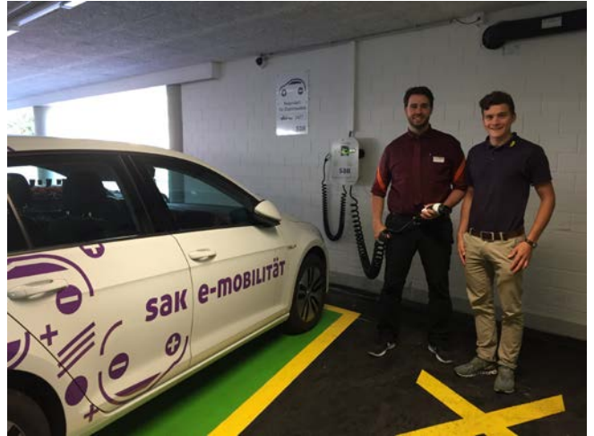
Freuen sich über die neu installierte Ladestation: Marcel Gantenbein, Filialleiter Migros Goldach (links) und Jan Müller, Projektleiter Elektroinstallationen SAK.
