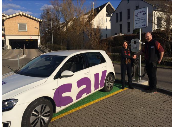
Freuen sich über die neu installierte Ladestation: René Frefel, Filialleiter Migros Embrach (rechts) und Alexandra Asfour Leiterin E-Mobilität der SAK.
